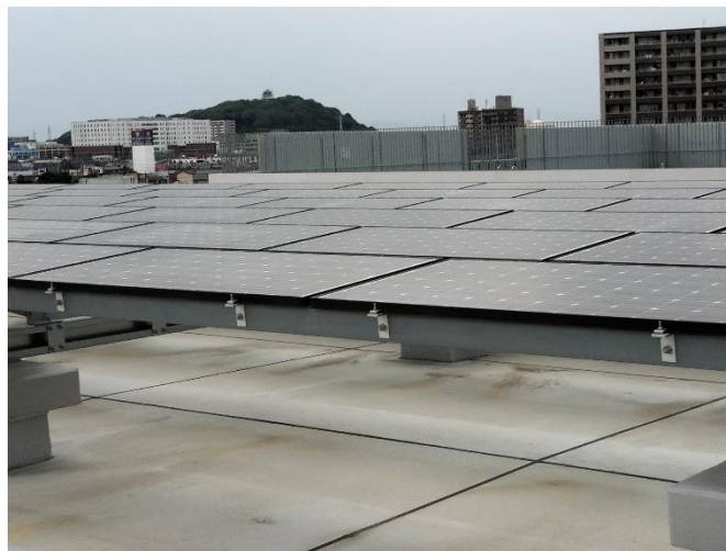
（屋上に設置された太陽光発電設備）【小牧市立小牧南小学校】
